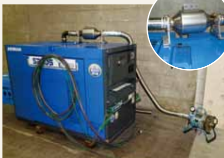
発電機 (25kVA) : モコビーDOC4+CTC1
